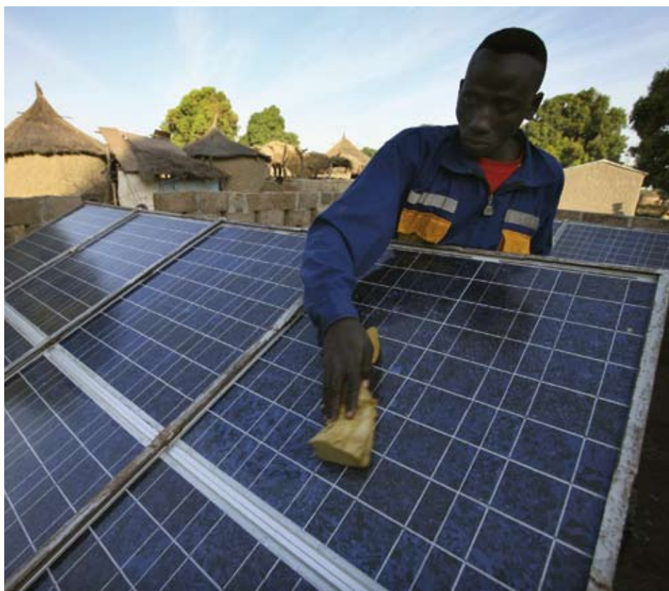
Panneaux solaires au Sahel.
